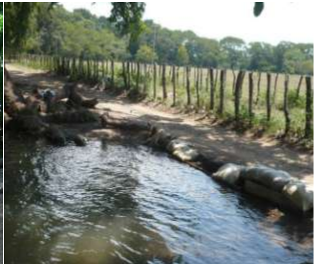
Foto 8. Dique construido sobre el cauce de la acequia y carretera aledaña afectada
