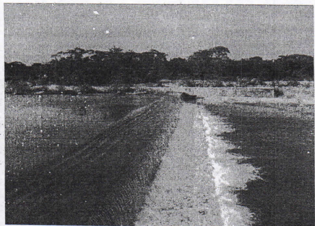
Imagen 12. Margen erosionada de la bocatoma
