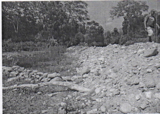
Imagen 12. Jarillón e infiltración de caudal
