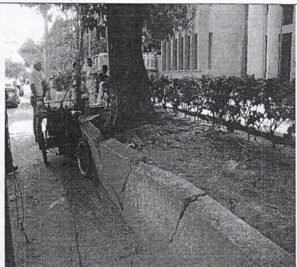
Detalle de los daños ocasionados a la infraestructura por el sistema radical del árbol de Roble.
