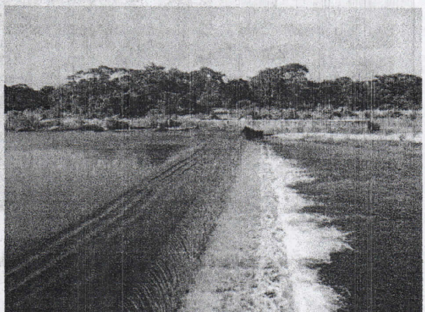
Imagen 12. Margen erosionada de la bocatoma
