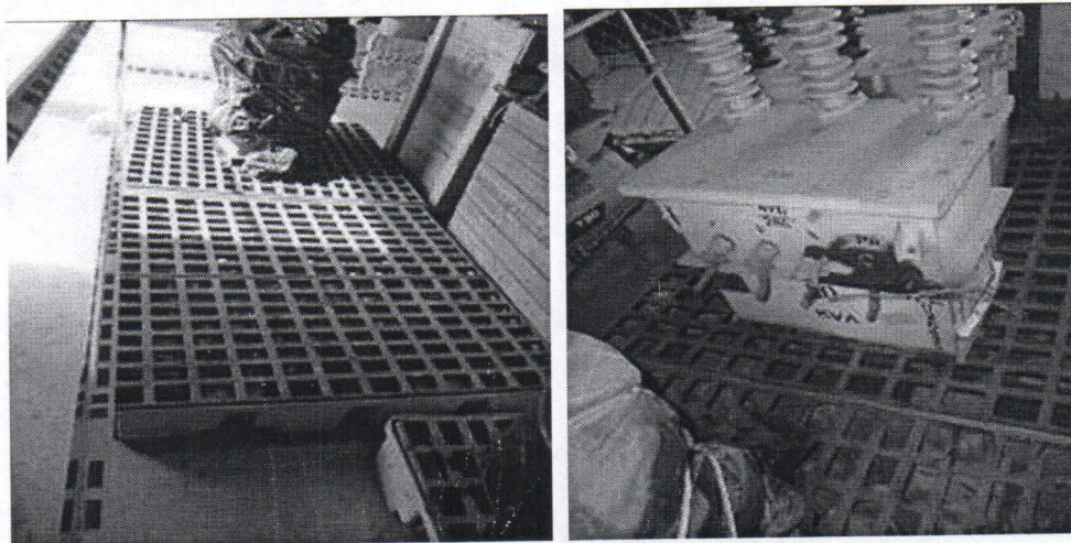
Fotografías No 2. Estibas de contención de derrames.
