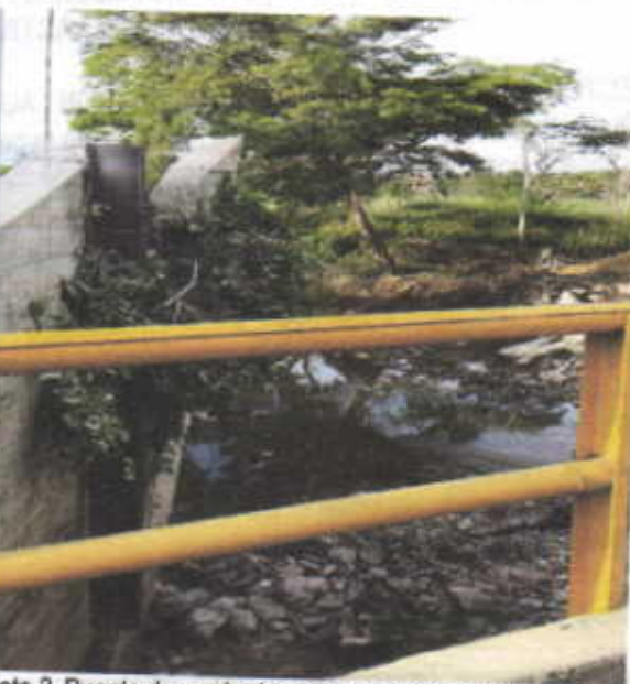
Foto 2. Puente derrumbado, material sobre el cauce.
