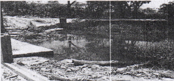
Imagen 15. Bocatoma bastante descuidada
