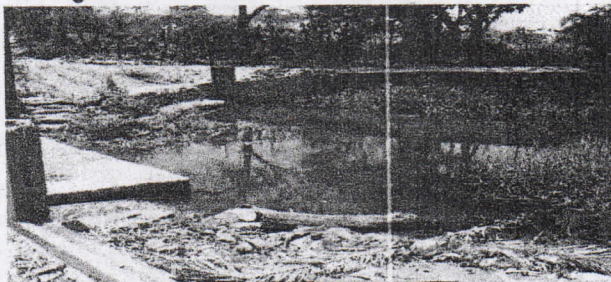
Imagen 15. Bocatoma bastante descuidada
