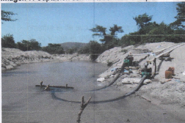
Imagen 7. Captación con motobomba río Tapias
