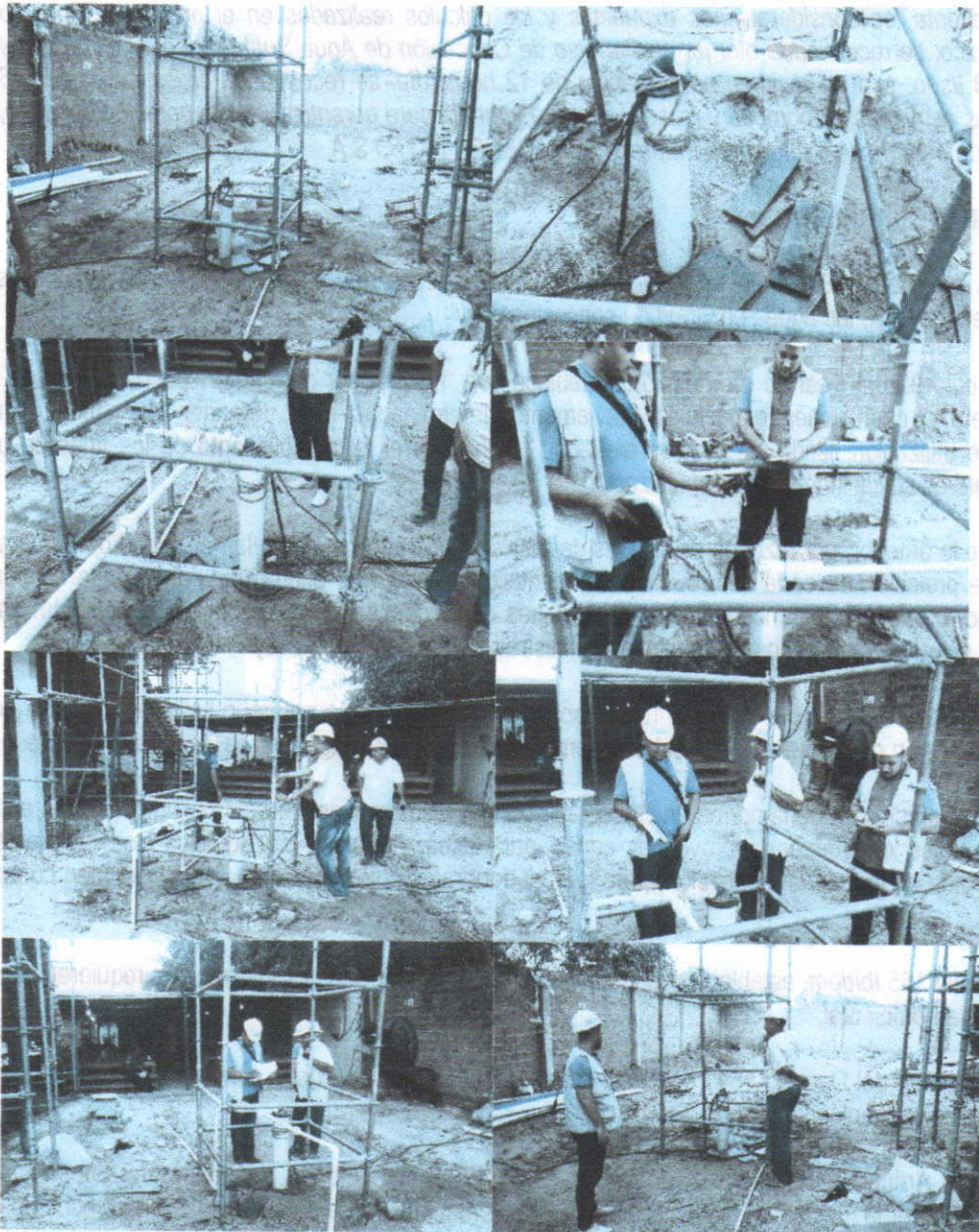
Fotografía No.5, 6, 7,8 Panorámica del ambiente que se observa alrededor del pozo.
