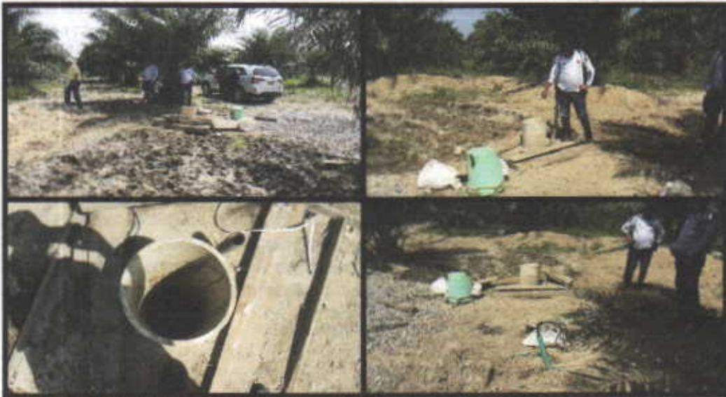
Fotografía No.1,2,3,4 Pozo de captación
