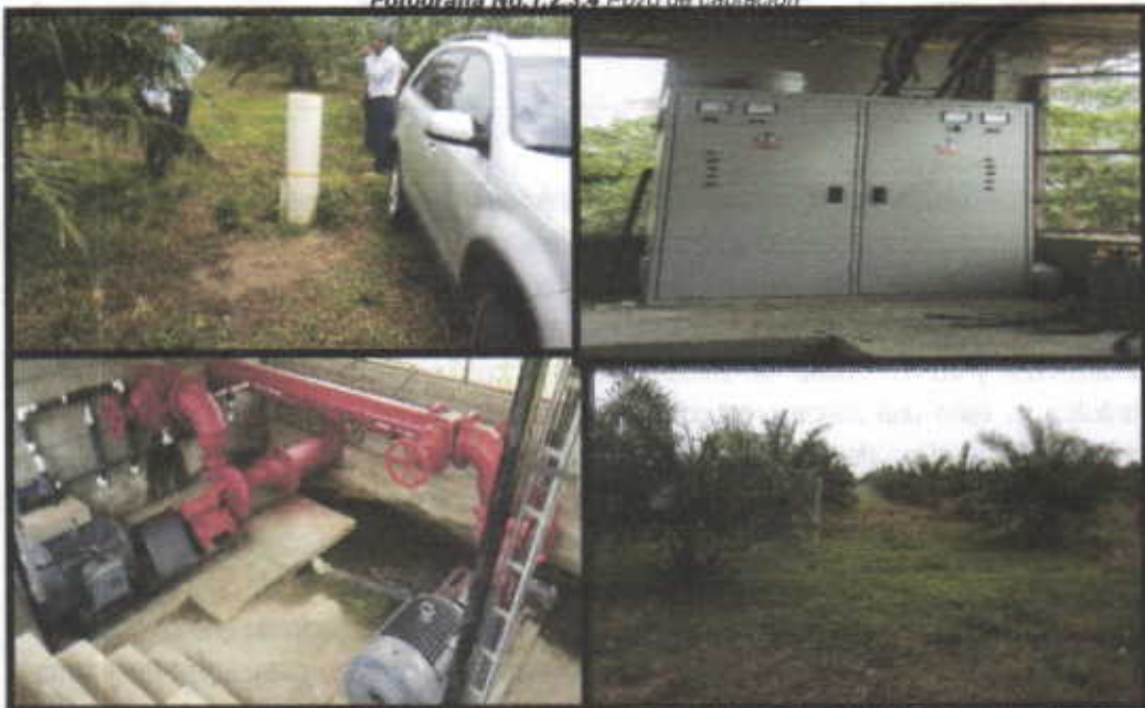
Fotografía No.5, pozo2 inactivo, 6, 7,8sistema de riego por aspersión caseta eléctrica de operación de bomba.
